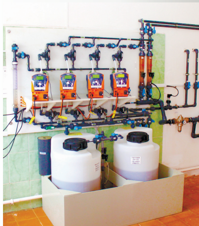
На снимке: фильтровальная станция цеха 008
