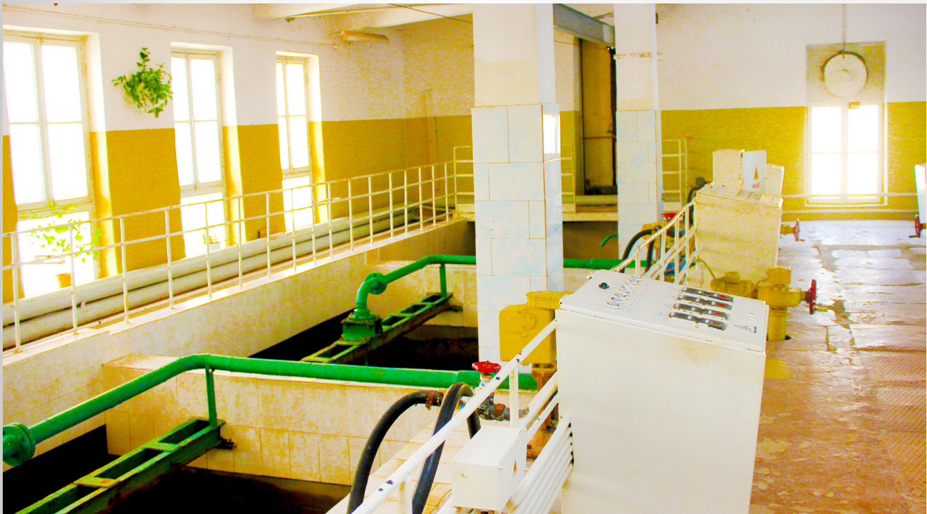
На снимке: фильтровальная станция цеха 008
